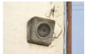
Lautsprecher einer „Ortsrufanlage“
